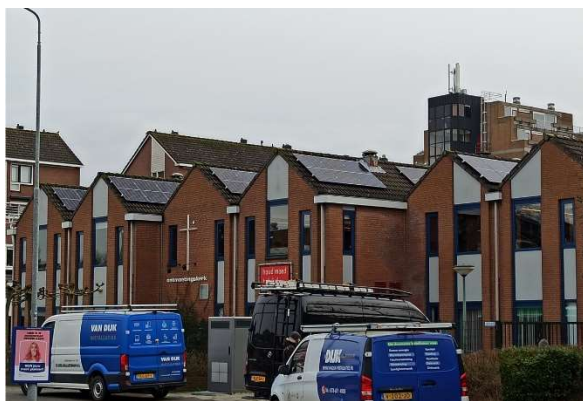
De panelen liggen op de daken
